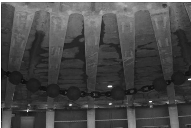
Rys. 2. Strop żelbetowy spękany na przestrzał w wyniku naprężeń termicznych wywołanych ciepłem hydratacji
