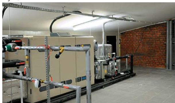
Ryc. 20. Wnętrze nowej centrali wentylacyjnej i klimatyzacyjnej Fig. 20. Interior of the new ventilation and air-conditioning control-room
