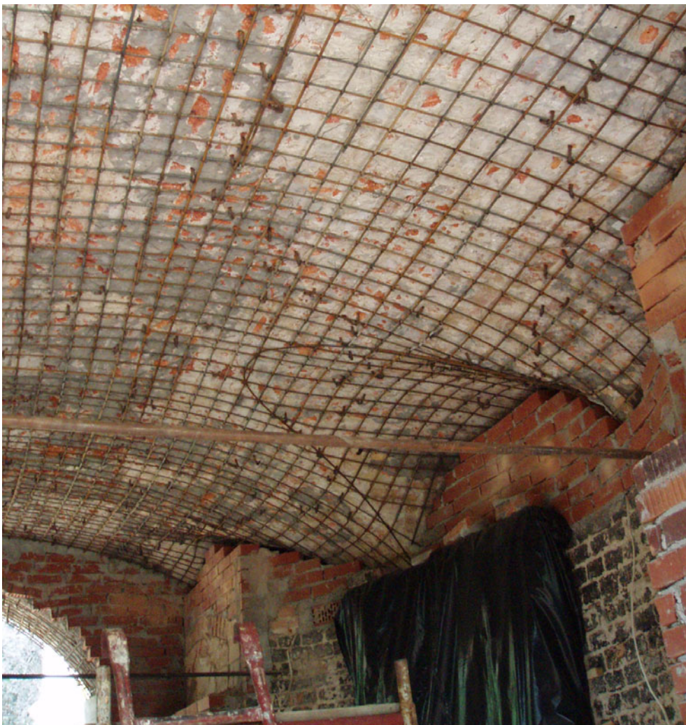
Rys. 10. Taras południowy – widok naprawy sklepienia Fig. 10. South terrace – view of the terrace vault being repaired
