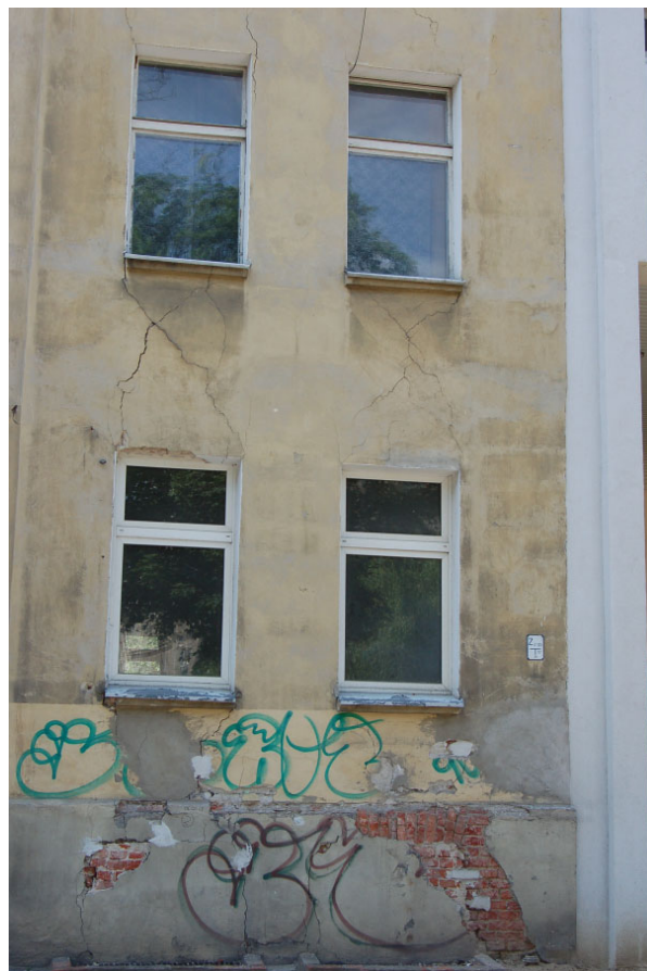
Rys.6 Uszkodzenia w poziomie przyziemia budynku istniejącego wywołane osiadaniami ściany szczytowej Fig. 6 Damage at the ground floor level of the existing building caused by the settlement of the gable wall
