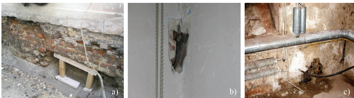
Rys. 4. a) zagłębienie fundamentu, b) rozwarście ścian w narożach, c) zawilgocenia piwnic Fig. 4. a) the depression of the foundation, b) opening in corners of the walls, c) rising damp of the cellars
