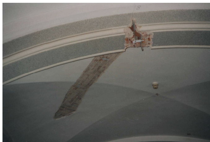
Rys. 3. Widok spękanego łuku A i części sklepienia nr 4 Fig. 3. View of the cracked arch A and part of vault no. 4
