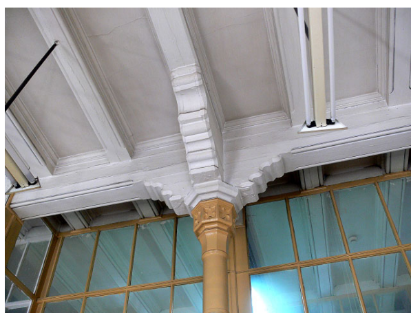
Rys. 8. Strop z powalą o profilowanych belkach drewnianych i profilowanych drewnianych podciągach Fig. 8. The ceiling with wooden beams of profiled cross-sections and wooden binding joists of profiled cross-sections
