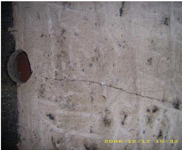
Rys. 6. Zarysowania niecki basenu [1] Fig. 6. Cracks in pool basin walls [1]
