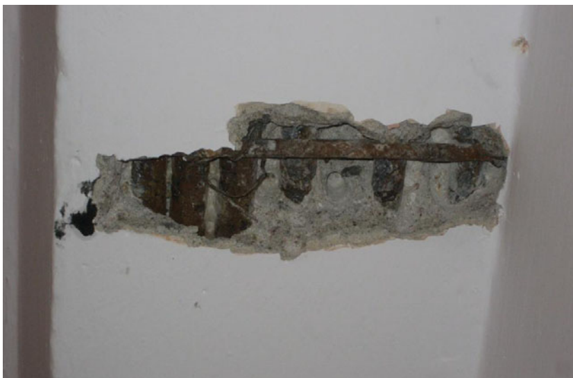
Rys. 4. Okrywka zbrojenia podciągu Fig. 4. Stripping of the joist reinforcement
