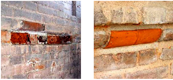
Fig. 6. Examples of "scuci-cuci" interventions on the bell tower of the Cathedral of Monza [4] Rys. 6. Przykłady interwencji typu „scuci-cuci” na dzwonnicy Katedry Monza [4]
