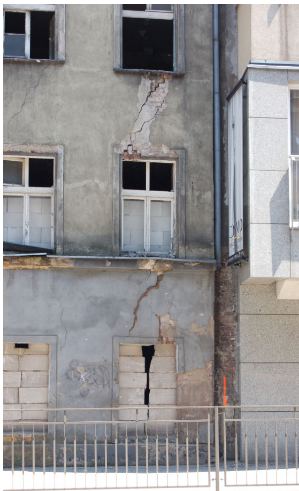
Rys. 2. Uszkodzenia w poziomie przyziemia starego budynku powstałe w wyniku osiadania fundamentu ściany szczytowej Fig. 2. Damage of the ground floor of the old building caused by the settlement of the gable wall foundation
