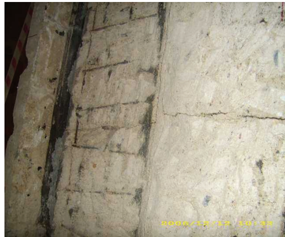
Rys. 7. Zarysowania niecki basenu [1] Fig. 7. Cracks in pool basin walls [1]
