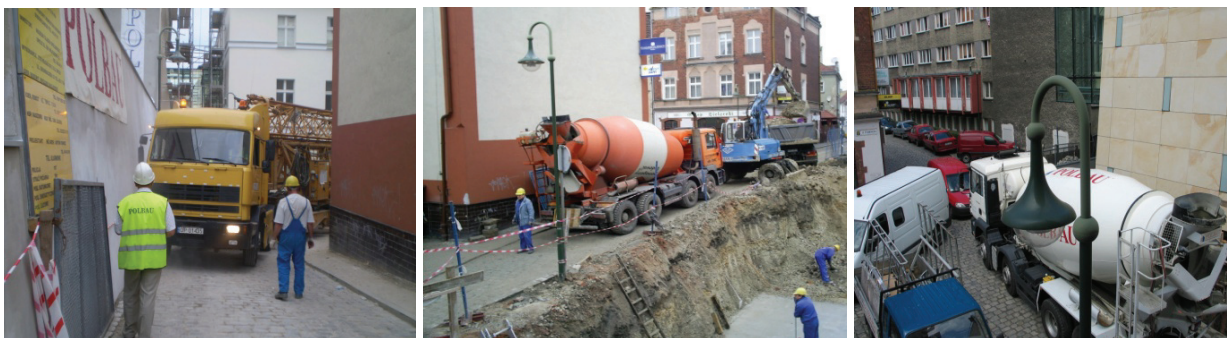
Rys. 3. Zaplecze oraz plac budowy Fig. 3. The builder's yard and the building site
