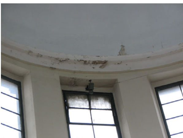
Rys. 7. Skrzydło południowe. Widok od dołu fragmentu kopuły kołowej. Widoczne ślady po przeciekach i rozwój grzybów pleśniowych Fig. 7. Southern wing. View of a fragment of circular dome. Visible traces caused by leakage and mildew fungus growth
