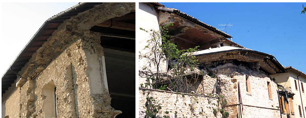
Fig. 2. R.C. roof pounding the masonry walls Rys. 2. Żelbetowy dach rozbijający murowane ściany
