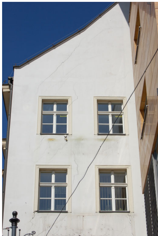
Rys.4. Ukośne spęknięcia ściany szczytowej spowodowane osiadaniem dalszej części ściany szczytowej istniejącego budynku Fig. 4. Diagonal cracks of the gable wall caused by the settlement of the further section of the gable wall of the existing building
