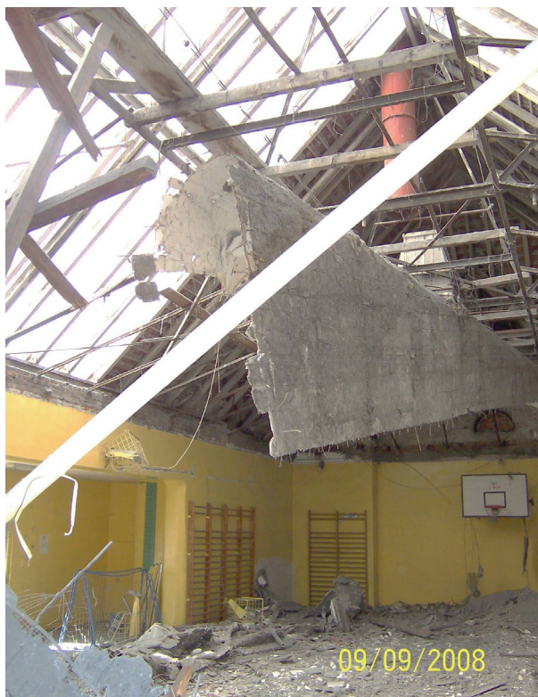
Rys. 3. Widok sufitu sali gimnastycznej przed katastrofą Fig. 3. View of the gymnasium's ceiling before the catastrophe
