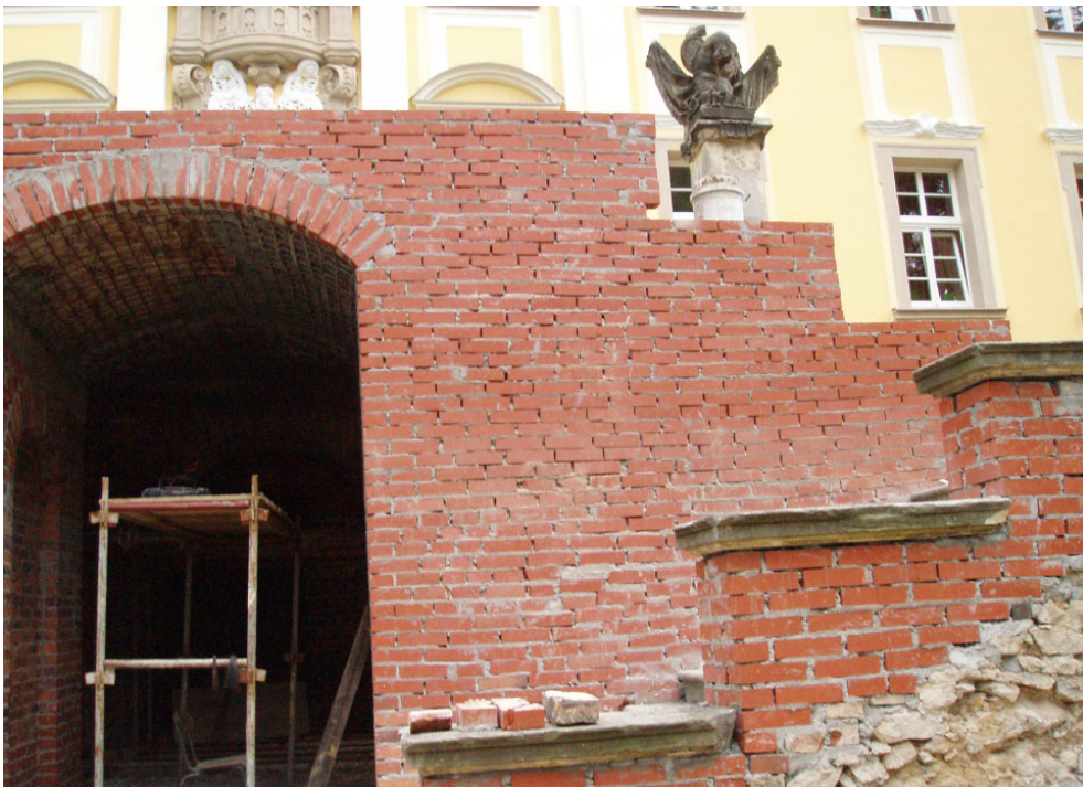
Rys. 9. Taras południowy – widok naprawy ścian tarasu oraz sklepienia Fig. 9. South terrace – view of the terrace walls and the vault being repaired
