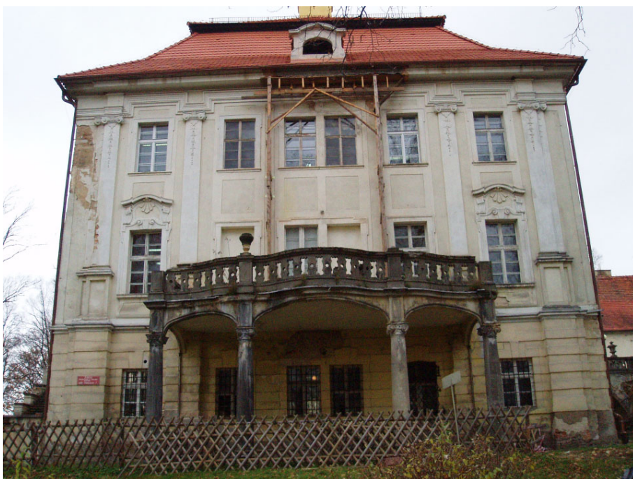
Rys. 3. Taras na elewacji wschodniej – widok przed remontem Fig. 3. East terrace – view before renovation
