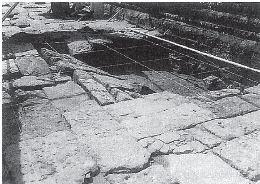
Fig . 3. Sagged and damaged pavement at the foundation along north-eastern side of Inner Gallery, where trenched in 1937 Rys. 3. Zapadnięty i uszkodzony chodnik przy fundamencie wzdłuż północno- wschodniej ściany Galerii Wewnętrznej, w miejscu wykopów z 1937 r.
