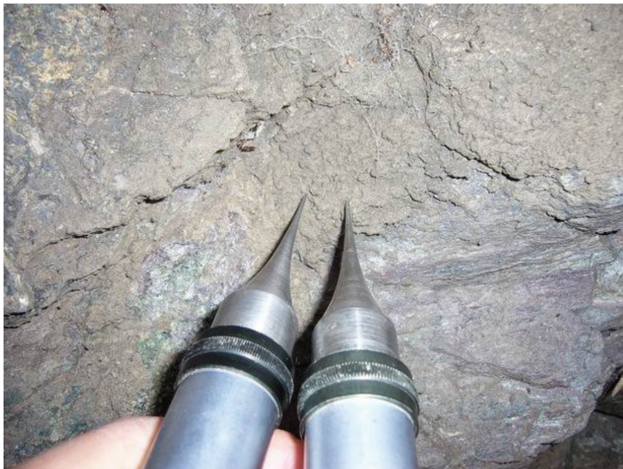
Rys. 8. Badanie zaprawy spoin metodą ultradźwiękową (fot. B. Stawiski) Fig. 8. Examination of mortar via ultrasound method (photo by B. Stawiski)
