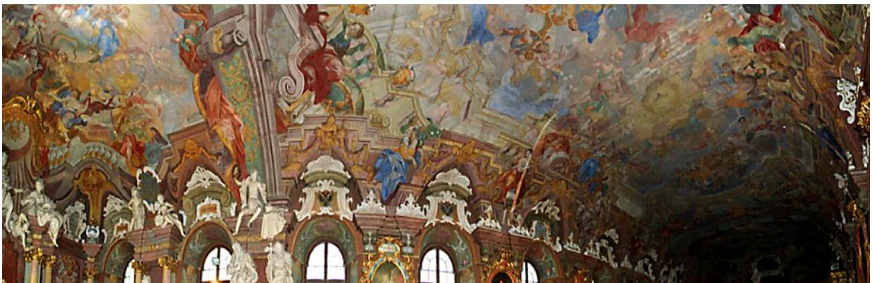
Rys. 3. Sufit – sklepienie pozorne Auli Leopoldyńskiej Fig. 3. The ceiling – apparent vault of The Leopoldina Hall
