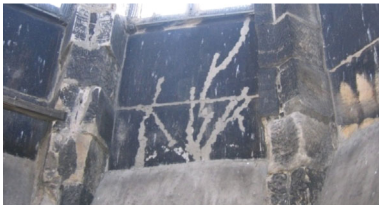
Rys. 5. Brak uszkodzeń w miejscu dawnych napraw metodą iniekcji Fig. 5. No damage in the old repaired places
