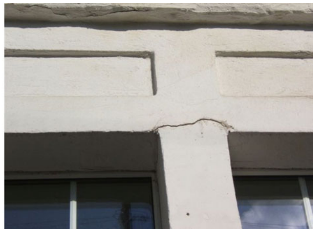
Rys. 5. Uszkodzenie filarka międzyokiennego Fig. 5. Damage of a pier in the elevation
