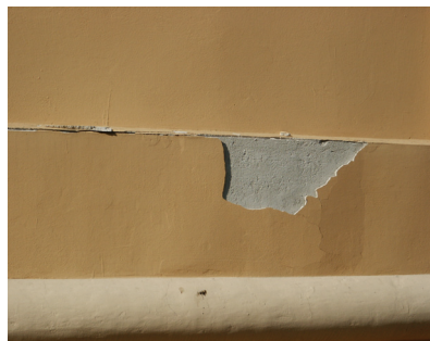
Rys. 3. Skutek zastosowania zbyt szczelnej zaprawy szpachlowej na tynku renowacyjnym
