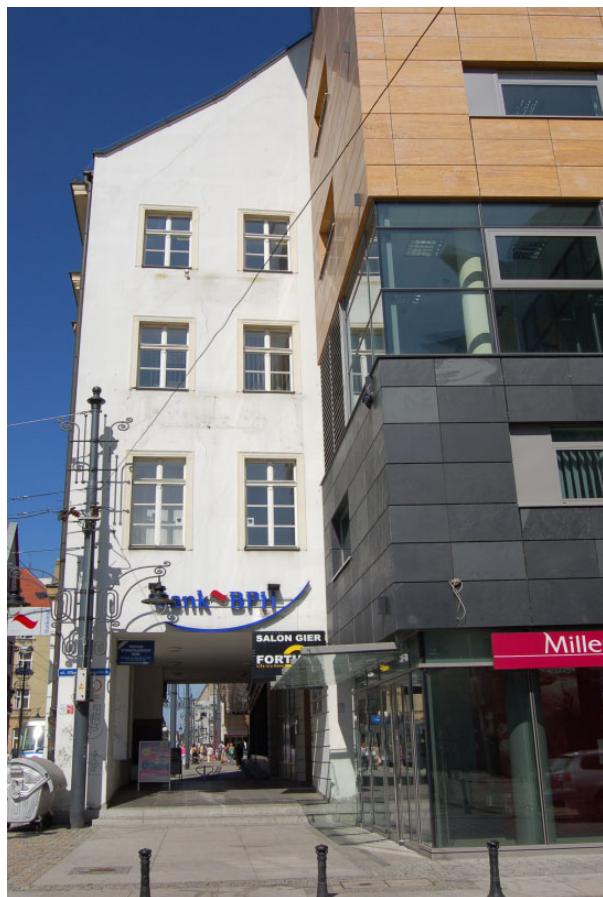
Rys. 3. Na pierwszym planie budynek dobudowany, w głębi spękana ściana szczytowa budynku istniejącego Fig. 3. Annexed building – in the foreground and cracked gable wall of the existing building – in the background
