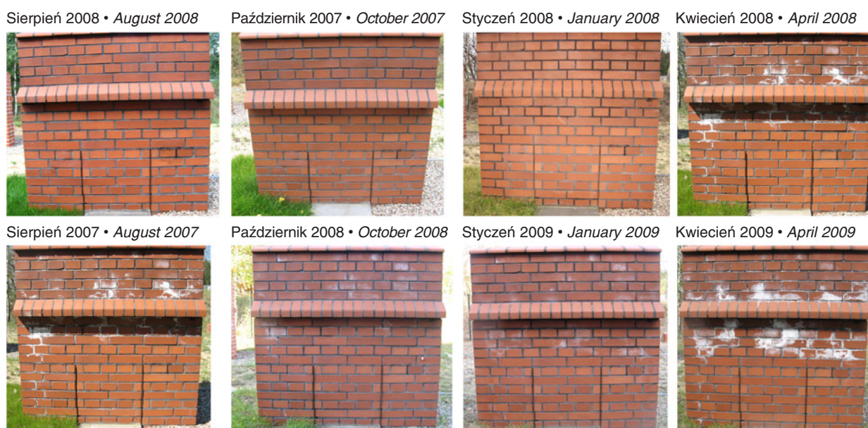
Rys. 4. Ewolucja wykwitów na murku testowym, wykonanym na zaprawie trasowej Fig. 4. Efflorescence formation on the test wall made on trass mortar
