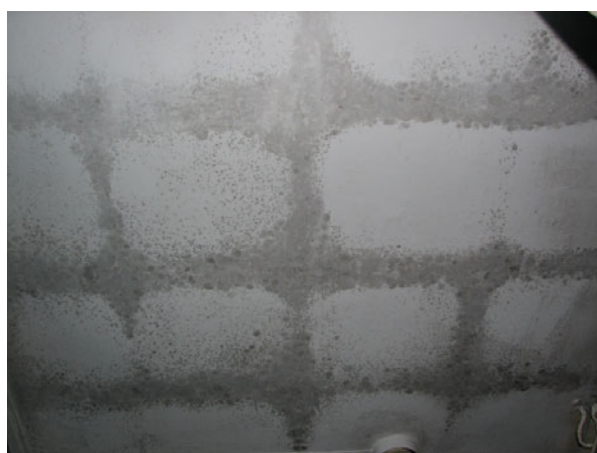
Rys. 8. Skrzydło południowe. Widok „przemarzających” żeber stropu. Główną przyczyną występowania tego zjawiska jest zbyt mała izolacyjność termiczna stropodachu Fig. 8. Southern wing. View of freezing slab-rib ceiling. The main reason for its occurrence is unsatisfactory thermal insulation of the flat roof
