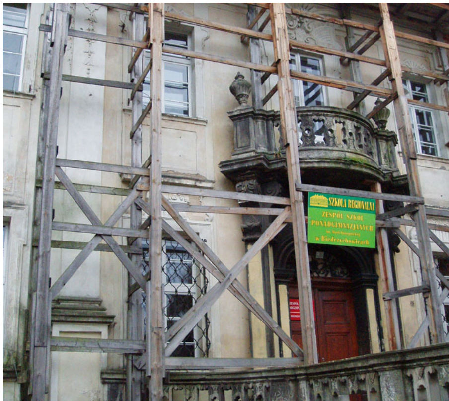
Rys. 1. Balkon nad wejściem głównym – widok przed remontem Fig. 1. Balcony above the main entrance – view before renovation
