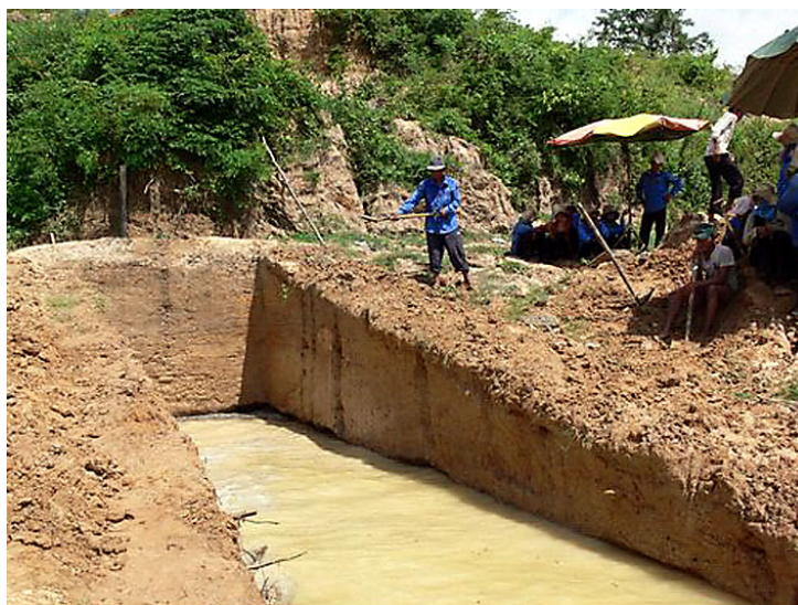
Fig. 8. The continued back filling practice without compaction in 2007 Rys. 8. Nadal stosowane zasypywanie bez zagęszczania w 2007 r.
