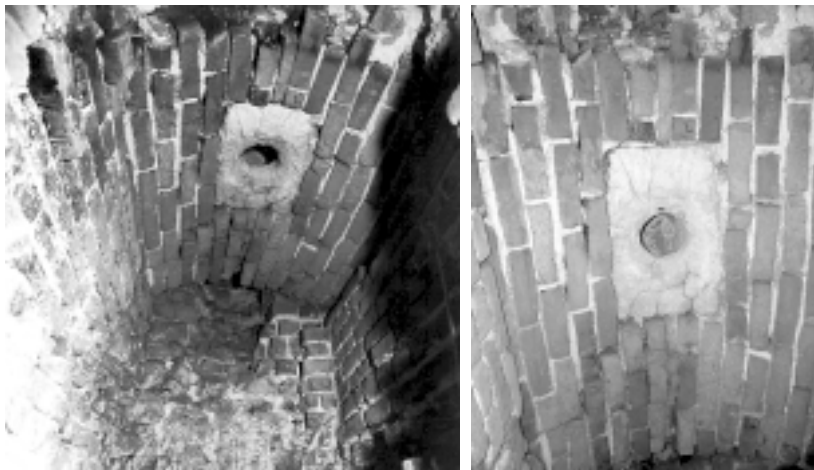
Ryc. 14. Klasztor augustianów w Krakowie, piec w piwnicy skrzydła wschodniego; widoczny cios wapienny z otworem wlotowym gorącego powietrza, umieszczony w podniebieniu sklepienia pieca. Fot. archiwalna T. Szklarczyk 1989, fot. stanu obecnego A. Bojęś-Białasik, 2009 Fig. 14. Augustinian monastery in Krakow, the stove in the east wing cellar; a limestone block with an inlet for hot air is visible, located in the soffit of the stove vault. Photo: archive, by T. Szklarczyk 1989, photo of the present state by A. Bojęś-Białasik, 2009
