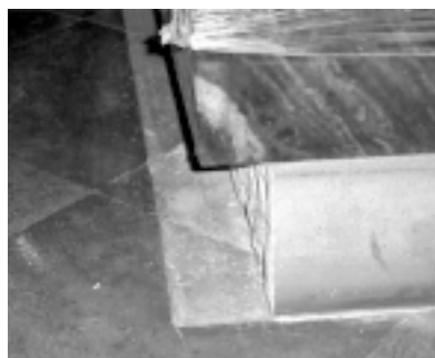
Ryc. 7. Podcięta część cokołowa Fig. 7. Undercut pedestal section
