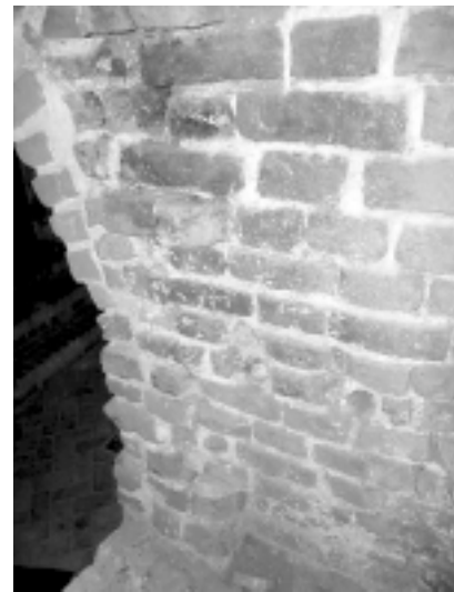
Ryc. 15. Okopczenia widoczne na powierzchni licowej zachodniej ściany komory wewnętrznej pieca. Fot. A.Bojęś-Białasik, 2009 Fig. 15. Soot black visible on the face of the west wall of the internal stove chamber. Photo by A. Bojęś-Białasik, 2009
