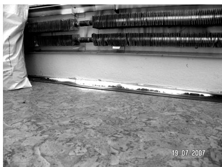
Fot. 3. Nieszczelność w konstrukcji budynku przy połączeniu podłogi ze ścianą szkieletową (fot. – G. Matuszczak) Photo 3. Leakage in building construction – floor and wall connection (photo by G. Matuszczak)
