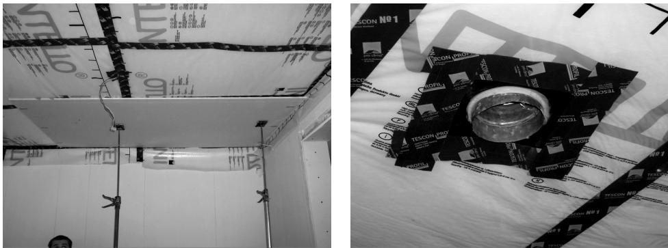
Fot. 6. Montaż folii paroprzepuszczalnej (fot. – M. Basińska) Photo 6. Assemble of nonriped sealed coverage (photo by M. Basińska)
