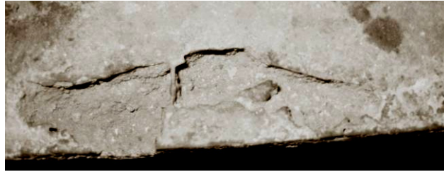
Rys. 18. Krawędź górnej półki dźwigara z widocznymi niedoskonałościami odlewniczymi
