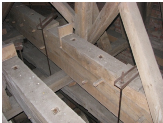
Rys. 9. Nowe belki (składane z 3 elementów) odciążające układ nośny więźby wieży. Poniżej widoczne podwieszane stare belki.
