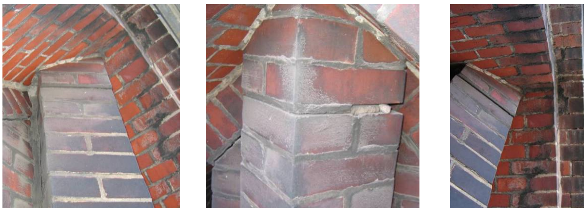
Rys. 5. Uszkodzenia słupa i gzymsów dolnej latarni Fig. 5. Damages of column and cornices of the lower lantern
