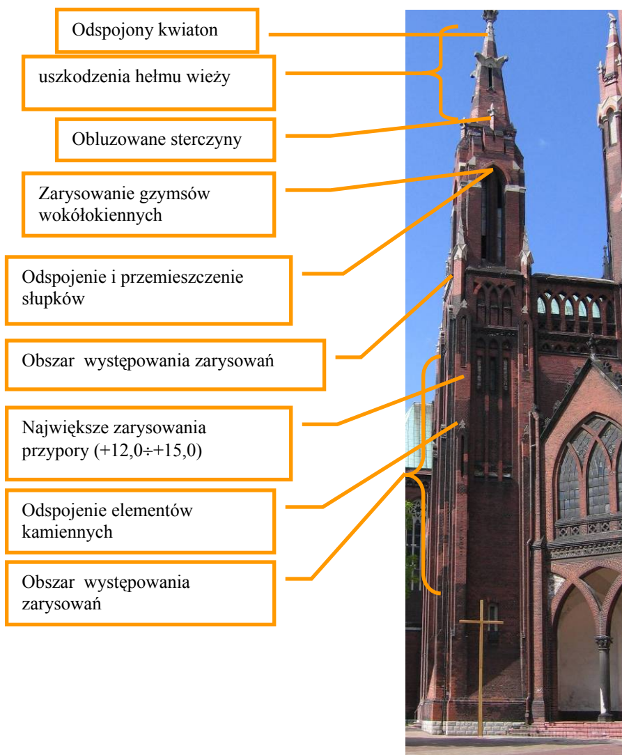
Rys. 7. Największe uszkodzenia wieży północnej zaznaczone na fotografii wieży naprawionej południowej (wykonano lustrzane odbicie fotografii wieży południowej)
