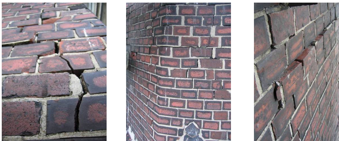
Rys. 4. Uszkodzenia hełmu wieży Fig. 4. Damages of the tower helmet
