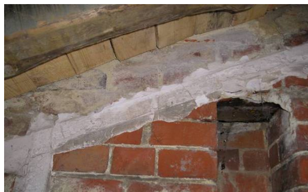
Rys. 28. Brak zarysowania pod stopniami biegu na ścianie północnej.
