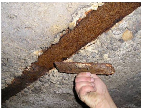
Rys. 14. Odpadające płyty korozji na dolnych półkach belek stropowych I180.
