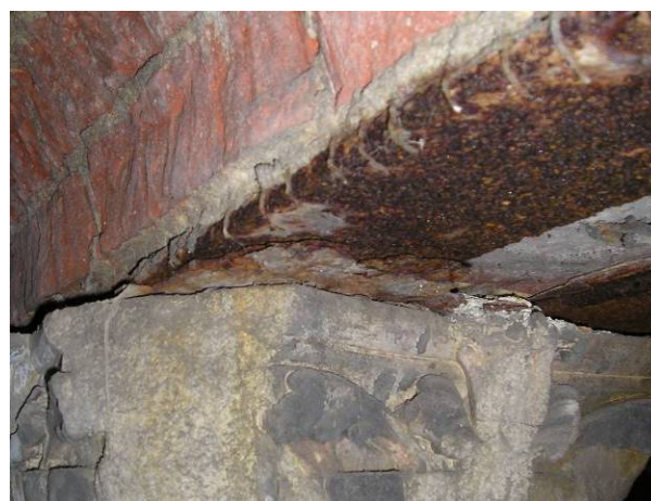
Rys. 15. Widoczne płyty korozji na dolnych półkach dźwigarów I330.
