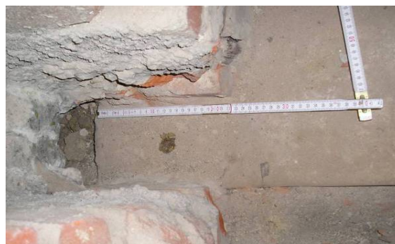
Rys. 26. Głębokość zakotwienia stopni w ścianie płn. wynosi 22 cm.
