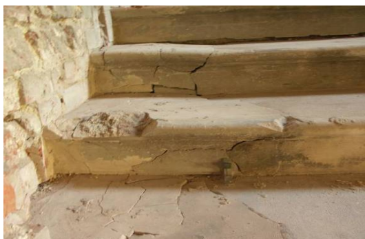
Rys. 25. Detale zniszczenia stopni biegu przy ścianie południowej.
