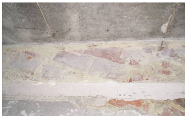
Rys. 27. Brak zarysowania pod stopniami biegu na ścianie zachodniej.
