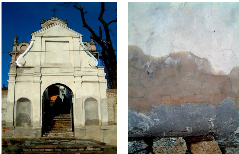
Rys. 12. Remont zabytkowych schodów na wzgórze, z wykorzystaniem tynków cementowo-wapiennych, sytuacja zastana parę miesięcy po wykonaniu prac.
