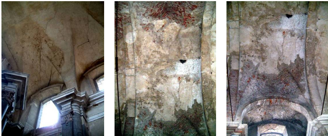
Rys. 7. Stan sklepień kościoła.
