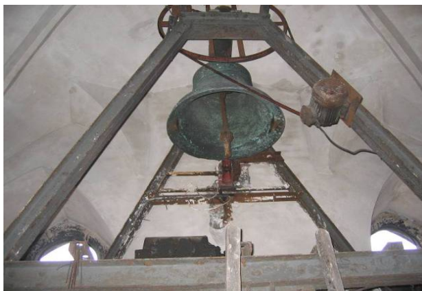
Rys. 2. Dzwon zawieszony na stalowej konstrukcji kozłowej Fig. 2. Bell on the steel trestle structure
