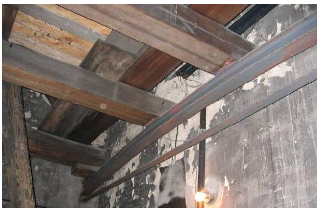
Rys. 3. Dawna konstrukcja stropu dzwonnicy z łukowymi stalowymi „amortyzatorami” Fig. 3. Old construction of bells tower floor with steel arch “shock absorbers”
