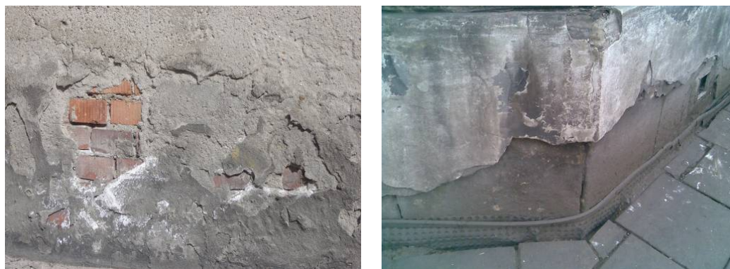
Rys. 6. Destrukcja tynku cementowego nałożonego na słabe i wilgotne podłoże.
