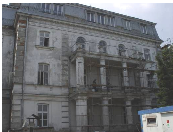
przed naprawą before repair works
