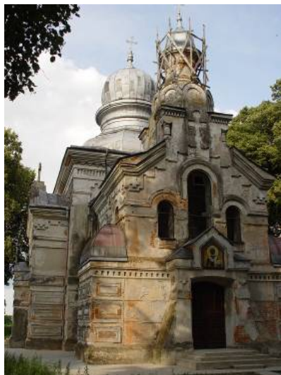
przed naprawą before repair works
