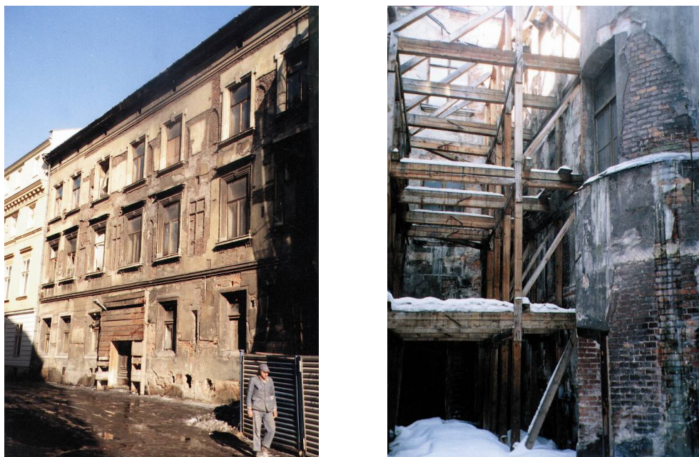
Rys. 4 Stan obiektu przed remontem
