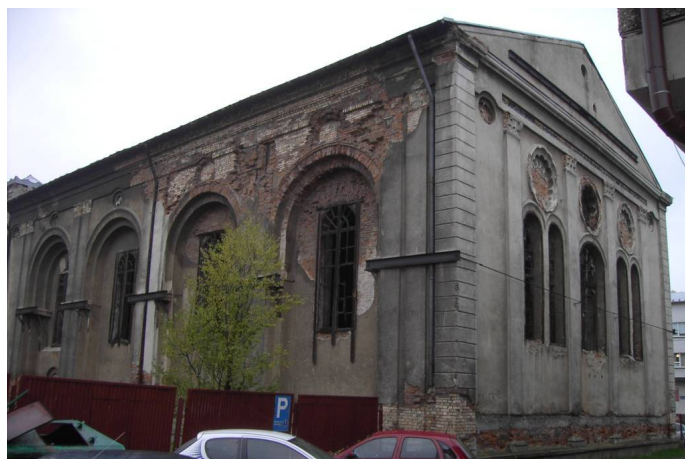
Rys. 3. Synagoga w Dąbrowie Tarnowskiej. Elewacje południowa i wschodnia. Widoczne prowizoryczne ściągi zamontowane w latach 70. XX w.
