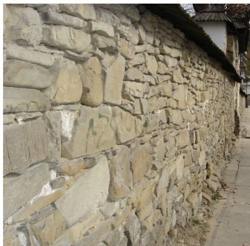
Rys. 1. Widok muru od strony ulicy (3 lata po przeprowadzeniu modernizacji ulicy)
