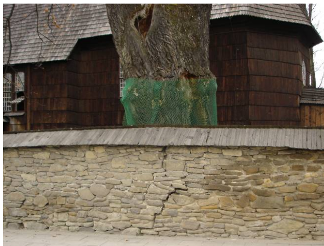
Rys. 2. Mur od strony zewn. w miejscu pęknięcia dylatacyjnego wywołanego rozrastaniem się drzewa
