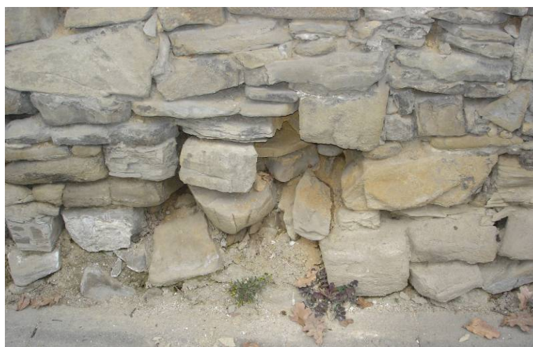
Rys. 4. Lokalne uszkodzenie muru po wykruszeniu zaprawy glinianej i wypadnięciu kamieni
