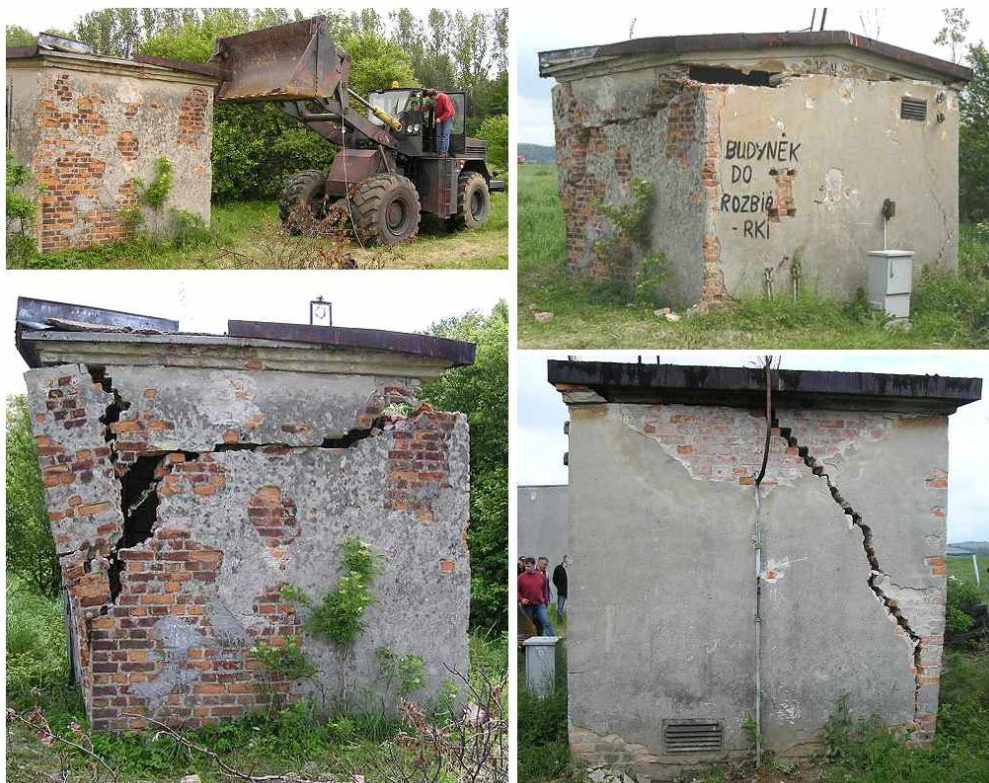
Rys. 6. Widok budynku po pierwotnym uszkodzeniu koparką Fig. 6. View of the tested masonry building after primary damage caused by the caterpillar hit
