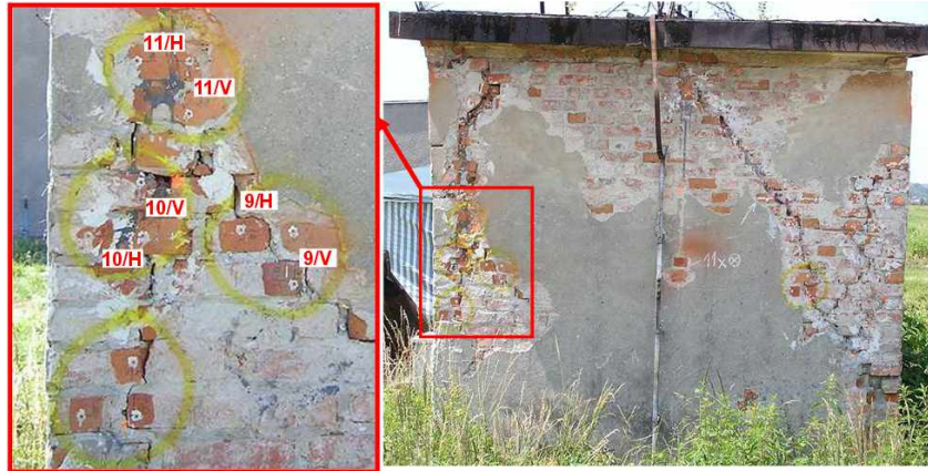
Rys. 10. Bazy tensometrii mechanicznej rozmieszczone na uszkodzeniach budynku
