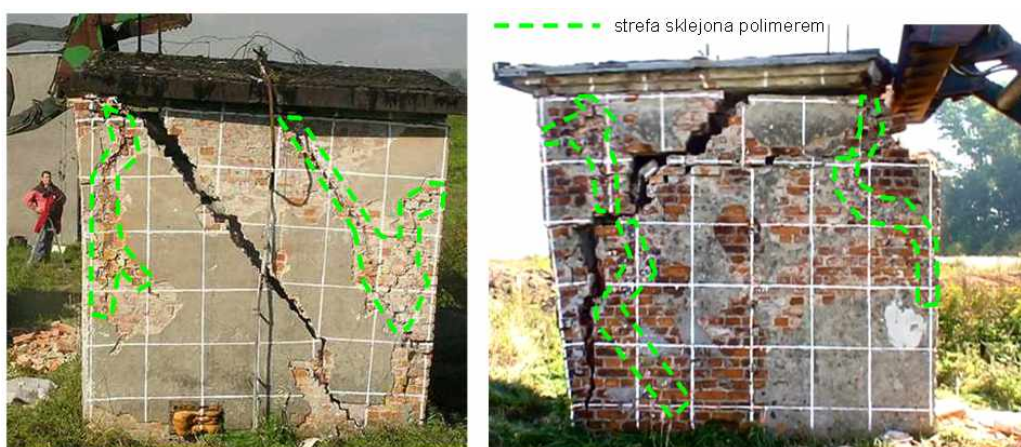
Rys. 15. Nowe uszkodzenia powstałe w naprawionej konstrukcji murowej, spowodowane przez siłę dynamiczną działającą w poziomie stropu oraz sklejone pęknięcia utrzymujące razem fragmenty ściany Fig. 15. New damages appeared in the repaired masonry, caused by the dynamic force excited at the roof level and the polymer bonded cracks keeping fast together pieces of wall
