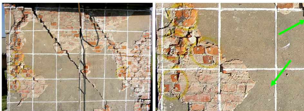
Rys. 13. Nowe pęknięcie w środku ściany wschodniej (po lewej) oraz wydłużenie się rysy poniżej bazy nr 9, zabezpieczonej na drugim końcu polimerem (po prawej)
