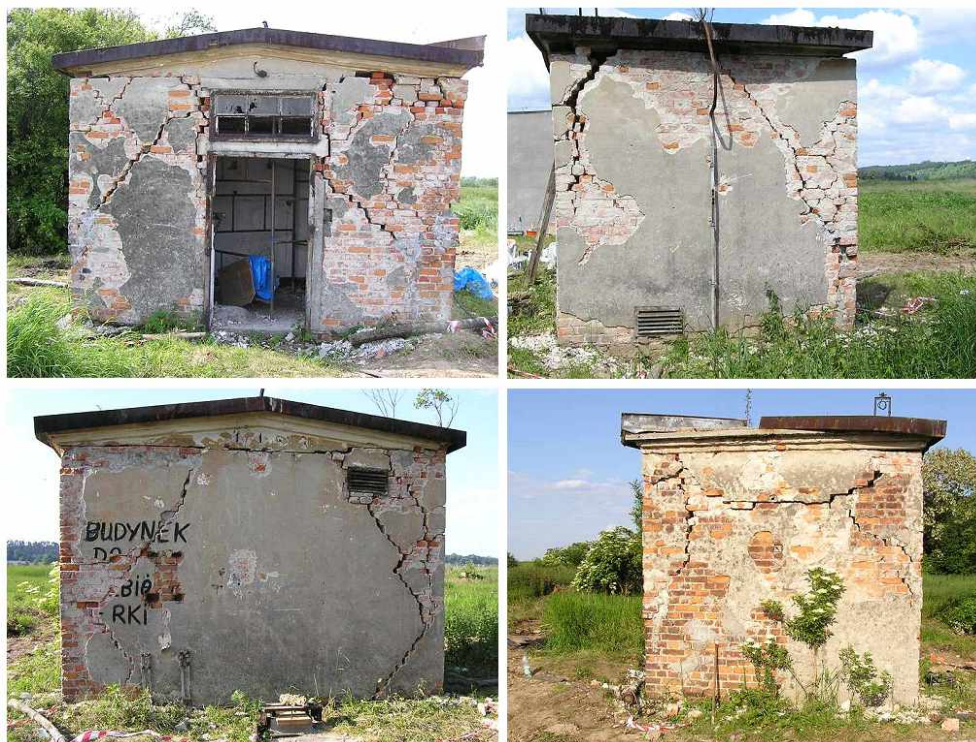
Rys. 7. Widok uszkodzeń wtórnych powstałych po prostowaniu konstrukcji Fig. 7. Damages of the building after rectification
