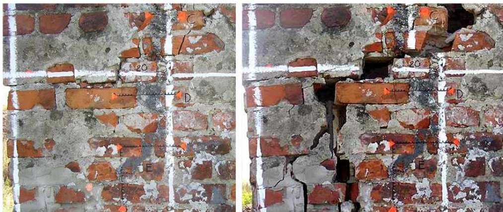
Rys. 14. Przebieg nowego pęknięcia na ścianie zachodniej przy nienaruszonej skleinie polimerowej Fig. 14. Trace of the new appeared crack on the west wall with non damaged polymer bond
