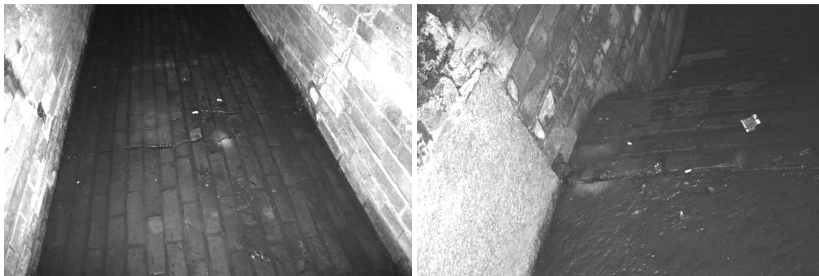
Rys. 4. Uszkodzenia wykonanej z cegły kinety kolektora
