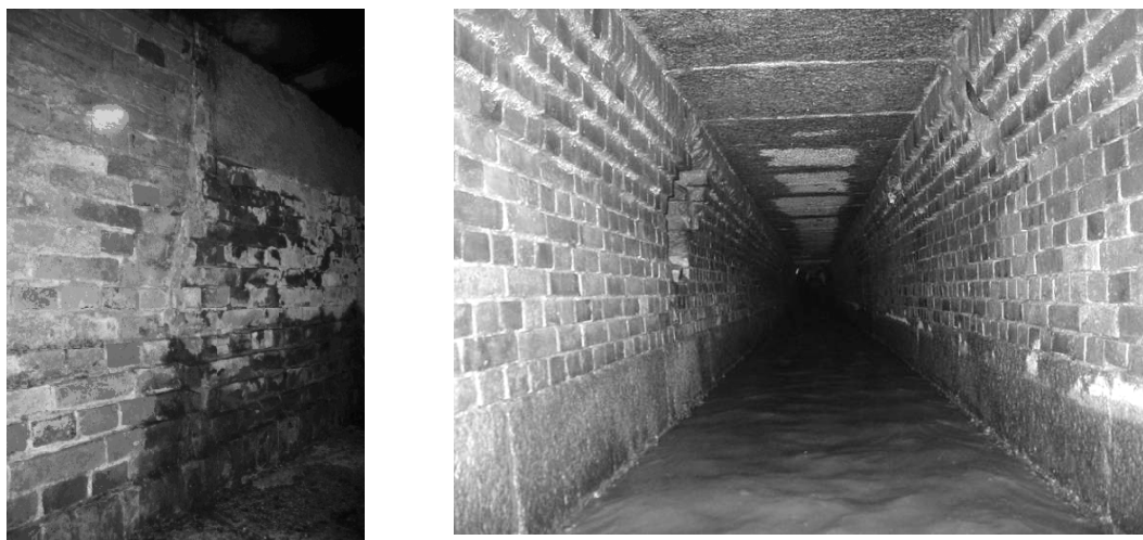
Rys. 3. Uszkodzenia ścian kolektora
