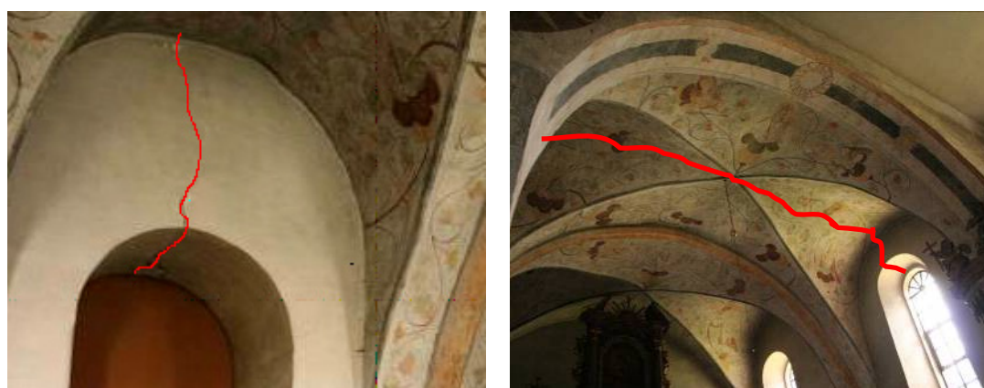
Rys. 11. Rysy na ścianach i sklepieniu prezbiterium Fig. 11. Cracks on walls and vault of presbytery
