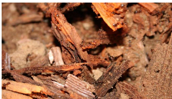
Rys. 13. Zupełna destrukcja belki stropowej przy podporze
