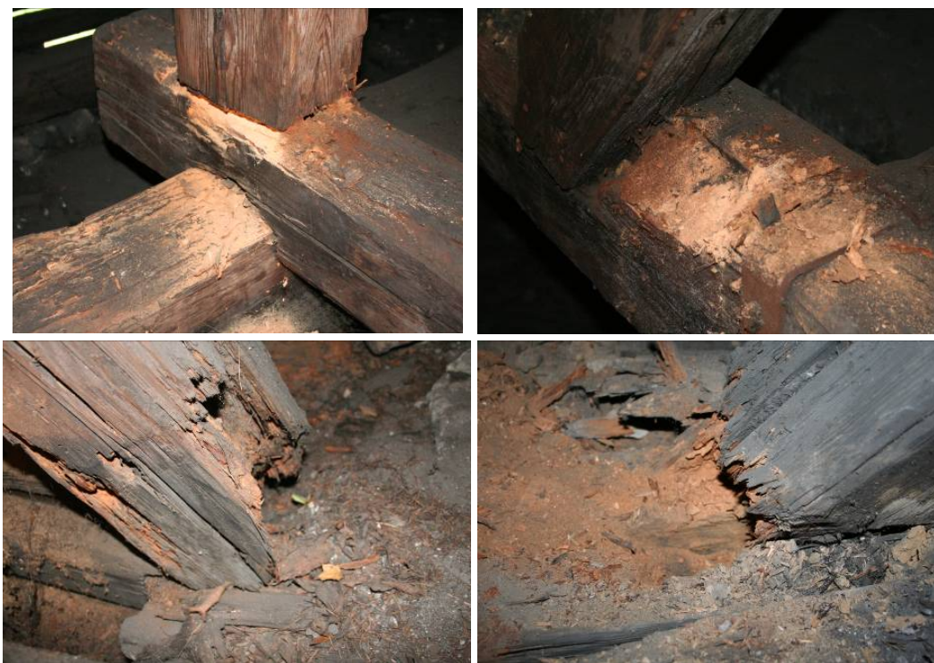
Rys. 12. Zniszczenia biologiczne drewnianej konstrukcji dachu
