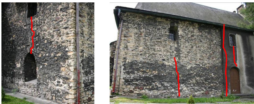
Rys. 10. Zarysowania na murach zakrystii Fig. 10. Cracks on sacristy walls
