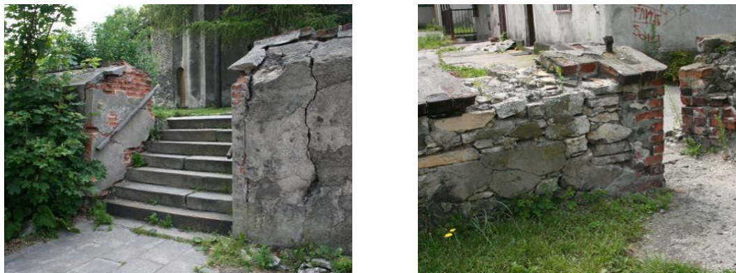
Rys. 14. Widoki zniszczeń muru okalającego kościół
