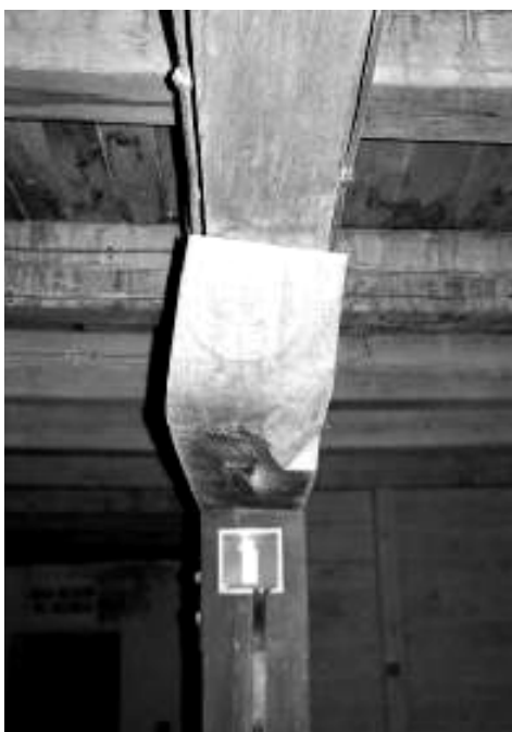
Rys. 8. Zwichrzony słup w budynku 11 Fig. 8. Warped column in building no 11
