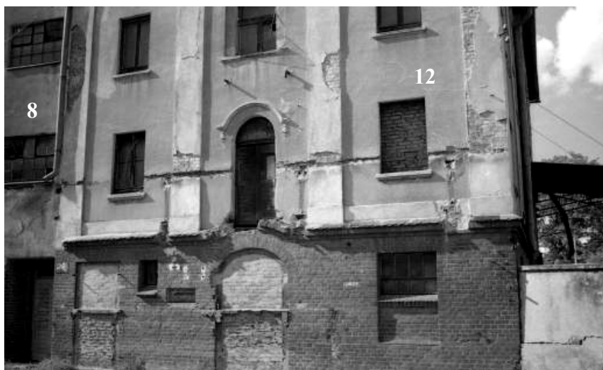
Rys. 12. Uszkodzenia elewacji budynku 12 Fig. 12. Damaged elevation of building no 12
