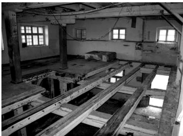
Rys. 11. Ubytki podłóg drewnianych na I kond. bud. nr 7 Fig. 11. Losses of timber floors on the first floor of building no 7
