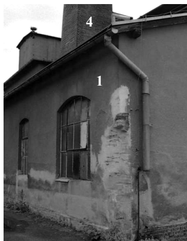
Rys. 10. Uszkodzony narożnik bud. nr 1 Fig. 10. Damaged corner of building no 1
