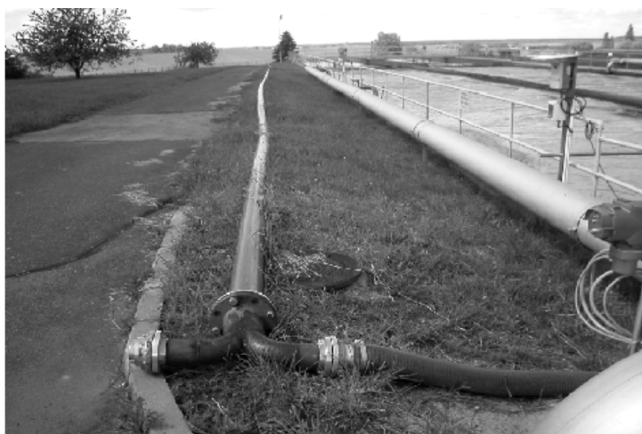
Fot. 1. Rurociąg dodatkowej recyrkulacji poprowadzony wzdłuż komór nityfikacji i denityfikacji
