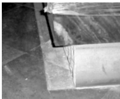
Ryc. 7. Podcięta część cokołowa Fig. 7. Undercut pedestal section
