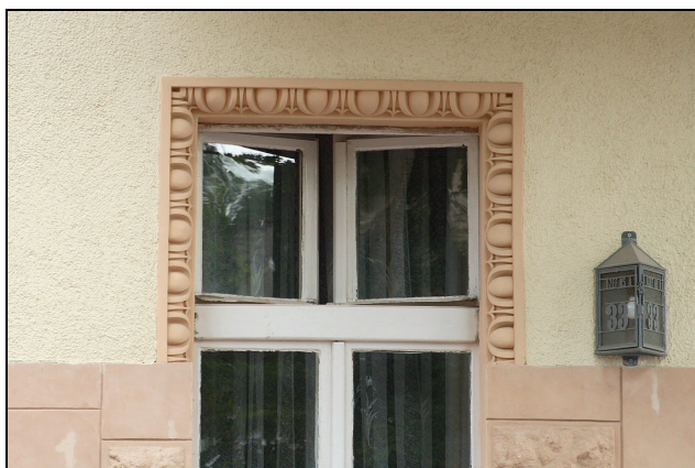
Rys. 11. Obramienie okienne wykonane w cemencie romańskim (detal kamienicy przy ul. Józefińskiej w Krakowie) Fig. 11. Window framing made in Roman cement (detail from the apartment house in Józefińska Street in Cracow)
