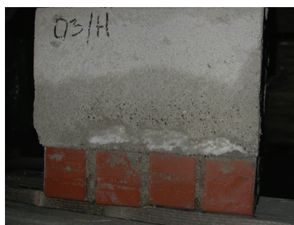
Rys. 2. Rezultat nałożenia tynku renowacyjnego w zbyt cienkiej, jednocentymetrowej warstwie
