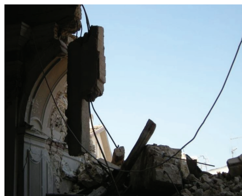
Fig. 11. Reinforced Concrete Beams (previous strengthening systems) participate to mechanism of collapse Rys. 11. Belki żelbetowe (poprzednio stosowany system wzmocnienia) przyczyniają się do zawalenia się budynków
