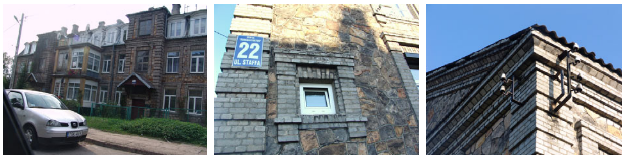
Rys. 4. Fragmenty elewacji budynków mieszkalnych w Skarżysku (fot. autor) Fig. 4. Parts of façade of housing buildings in Skarżysko (photo by author)
