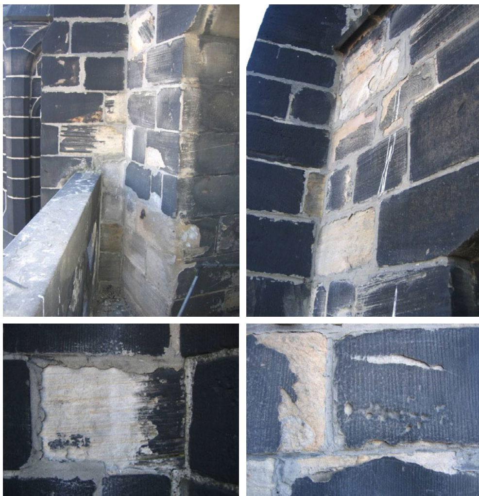
Rys. 8. Ubytki elementów kamiennych spowodowane spoinowaniem zaprawą cementową Fig. 8. Defect of the stone masonry units caused by cement mortar pointing
