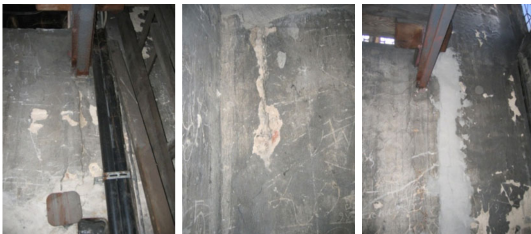
Rys. 4. Zarysowania murów pod dawną konstrukcją wsporczą pod dzwony Fig. 4. Masonry scratches under the old bell-supporting structure
