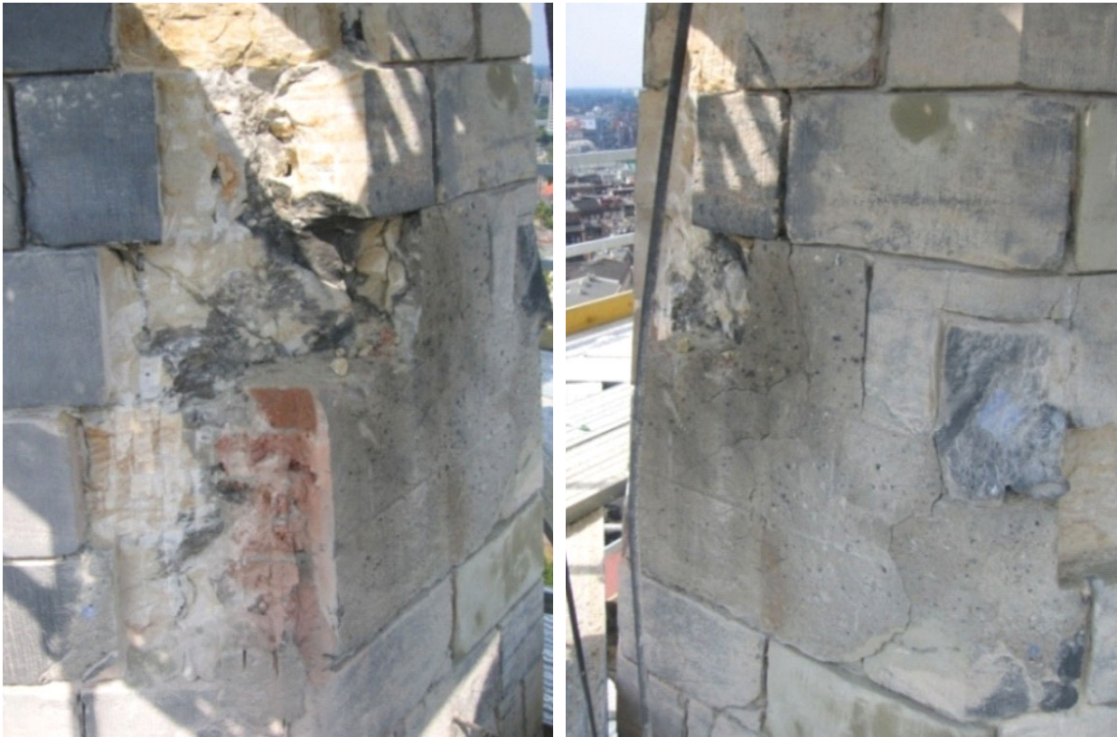
Rys. 6. Dawne naprawy w miejscu uszkodzeń spowodowanych ostrzałem artyleryjskim Fig. 6. Previous repairs to the places damaged in the artillery fire
