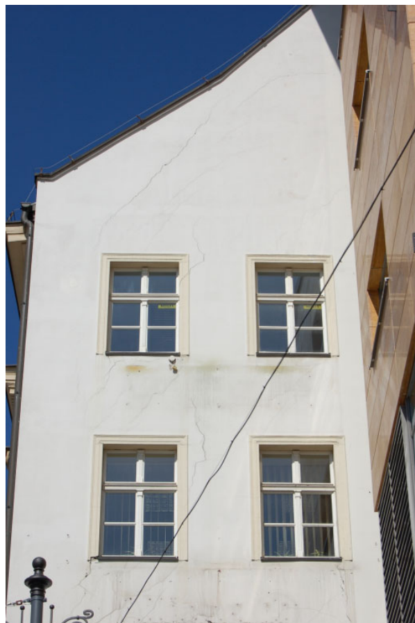
Rys. 4. Ukośne spęknięcia ściany szczytowej spowodowane osiadaniem dalszej części ściany szczytowej istniejącego budynku Fig. 4. Diagonal cracks of the gable wall caused by the settlement of the further section of the gable wall of the existing building
