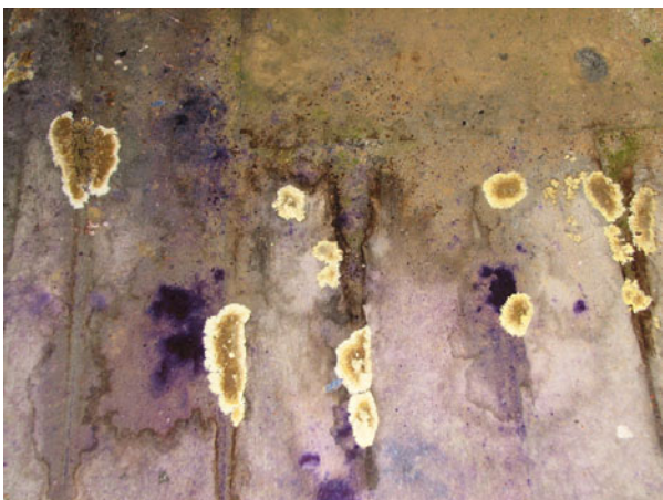
Rys. 5. Skrzydło północne. Widok porażenia desek podłogowych przez grzyba domowego właściwego Fig. 5. Northern wing. View of wooden floor damages caused by house fungus
