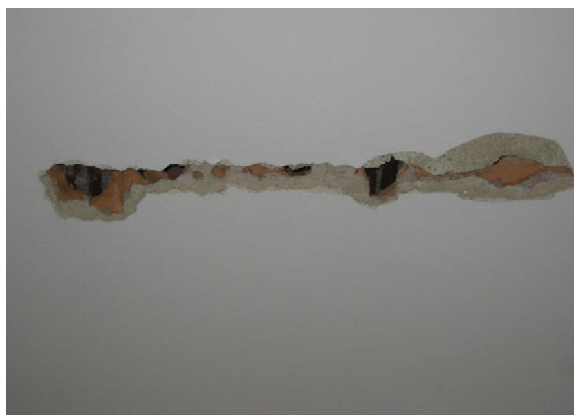
Rys. 3. Okrywka konstrukcyjna zbrojenia stropu Fig. 3. Stripping of the ceiling slab reinforcement
