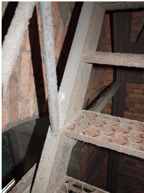
Rys. 10. Korozja Fig. 10. Corrosion
