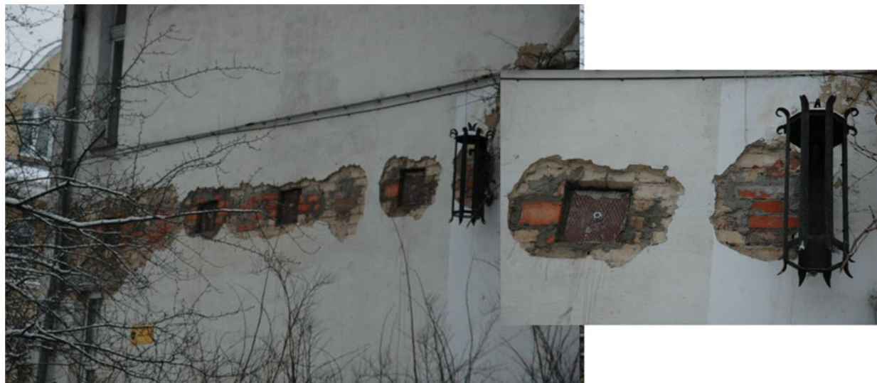
Rys.11. Widok blach zewnętrznych dodatkowych stężeń muru Fig. 11. External plates of additional wall bracing
