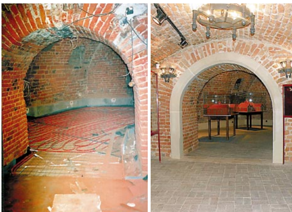
Ryc. 1. Zamek w Dzikowie. Piwnica 1, przed i po remoncie Fig. 1. Dzikow castle. Cellar 1, before and after the renovation
