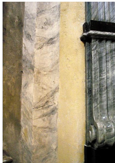
Ryc. 7. Wnętrze neobarokowej klatki schodowej – stan po konserwacji Fig. 7. Interior of the Neo-Baroque staircase – after conservation
