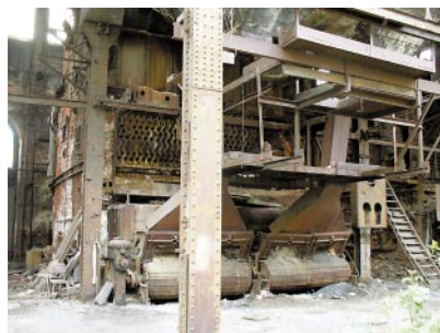
Elektrownia na Kazimierzu. Hala kotłowni. Na pierwszym planie silosy na węgiel, w głębi pozostałości kotła Babcock-Wilcox. Stan obecny. Fot. autor
