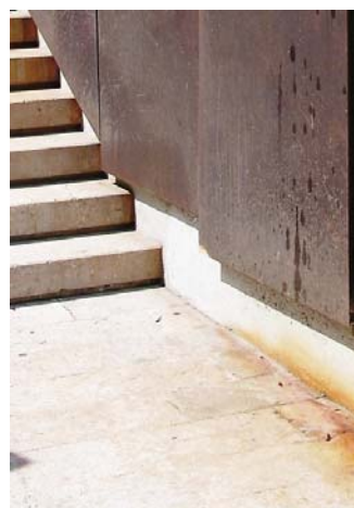
Ryc. 6. Zniszczone schody terenowe przez zacieki ze ściany osłonowej z surowej stali. Brak separatorów i elementów odwodnienia liniowego (Alikante – Hiszpania)
