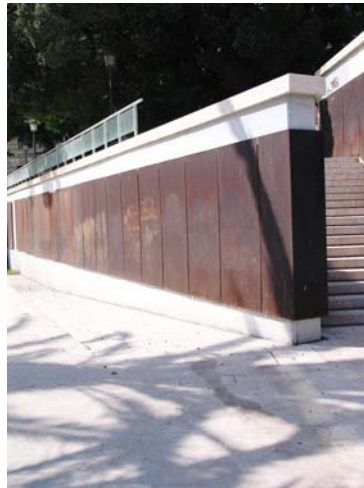
Ryc. 2. Ściana osłonowa ze stali surowej – brak drenaży i absorberów (Alicante – Hiszpania)
