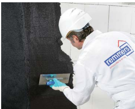
Ryc. 1. Powłokę bitumiczno-polimerową nakłada się w dwóch warstwach, pierwszą warstwę wykonuje się, używając pacy ząbkowanej, a drugą – używając pacy gładkiej
