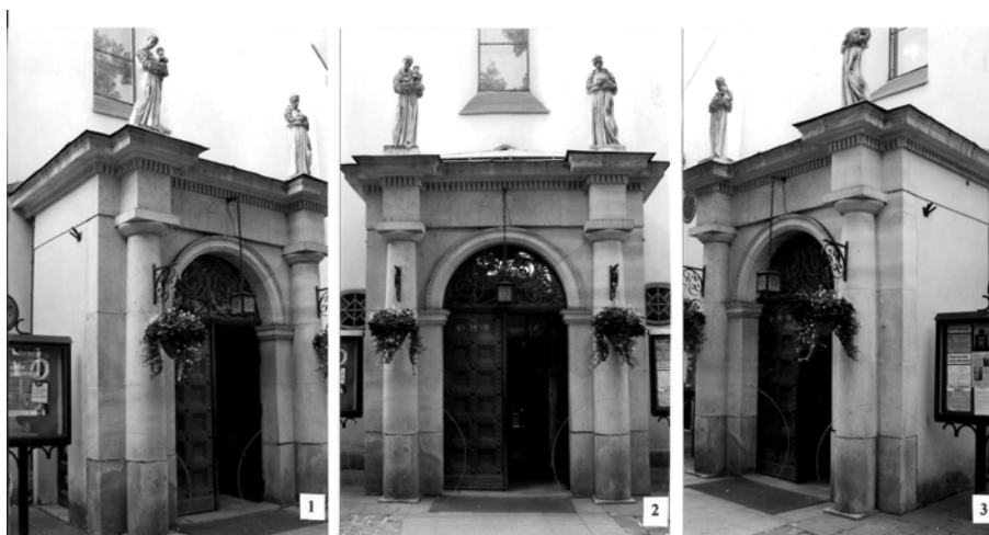
Ryc. 1, 2, 3. Widok elewacji frontowej krużdy wejściowej do kościoła – na fragmentach kolumn z obu stron wejścia wyraźnie widać przesunięcia i odspojenia
