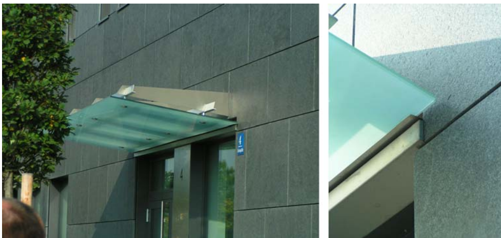
Ryc. 2. Budynek biurowy, Monachium: szklane zadaszenie nad głównym wejściem do budynku, detal odwodnienia. Fot. Łukasz Wesołowski
