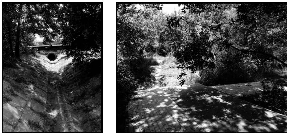
Ryc. 2. Fotografie ukazują betonowe koryto potoku Biezanówka (po lewej) oraz zrealizowaną ostatnio ścieżkę prowadzącą w „chaszczce”, fot. aut.
