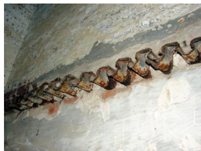
Ryc. 11. Stropowa blacha fałdowa
