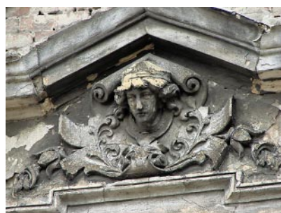
Ryc. 13. Przykład zewnętrznej nadokiennej ozdoby, bogaty wystrój plastyczny odpada od ścian
