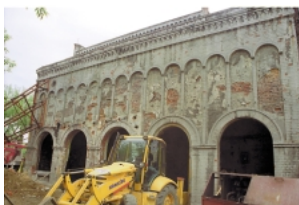
Elewacja północna (obecnie kaplice) pokryta warstwą cementowej obrzutki
