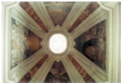
Rys. 4. Kopuła w Owieńskach – spękania na kopule nawy centralnej. Zaznaczono południkowe kierunki biegu spękań [1], [2], [3]
