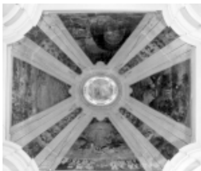
Rys. 3. Kopuła w Owieńskach – spękania na kopule nawy centralnej – stan z 1952 roku
