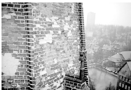
Rys. 5. Szczegół uszkodzeń warstwy licowej – połacie zachodnia
