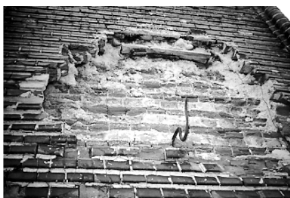
Rys. 6. Szczegół uszkodzeń warstwy licowej – połacie południowo-zachodnia
