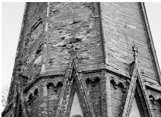
Rys. 4. Widok uszkodzeń warstwy licowej (połacie zachodnia, południowo-zachodnia i południowa)
