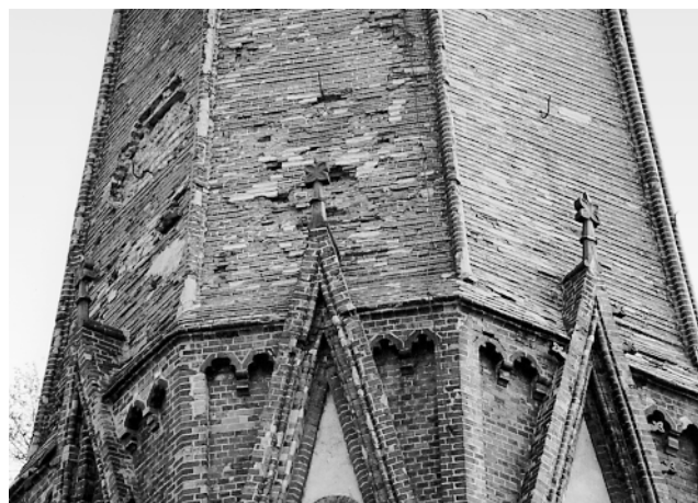
Rys. 4. Widok uszkodzeń warstwy licowej (połacie zachodnia, południowo-zachodnia i południowa)
