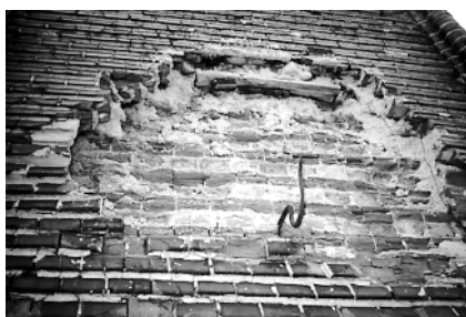
Rys. 6. Szczegół uszkodzeń warstwy licowej – połacie południowo-zachodnia
