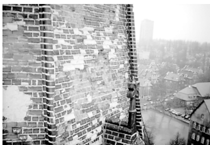
Rys. 5. Szczegół uszkodzeń warstwy licowej – połacie zachodnia
