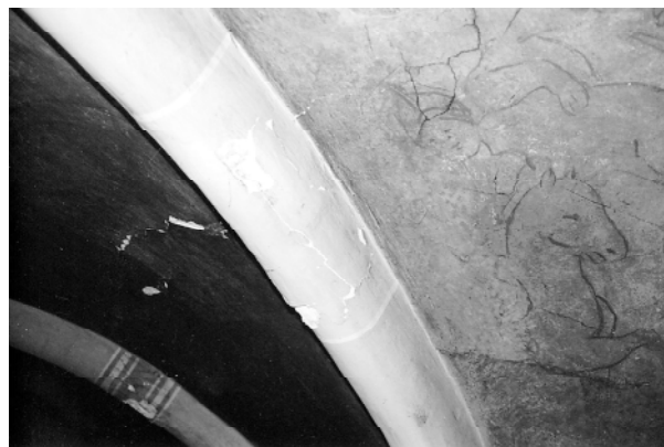
Fot. 34. Widok zewnętrzny uszkodzonej strefy żebra
