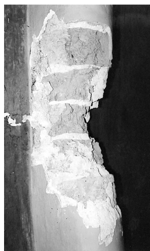
Fot. 35. Zasięg uszkodzenia żebra z fot. 34
