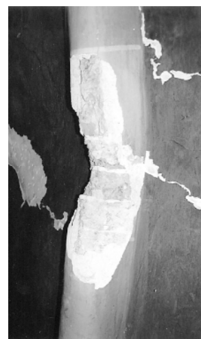
Fot. 36. Zasięg uszkodzenia żebra
