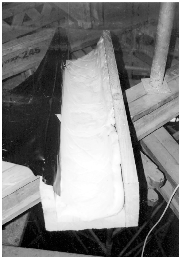
Fot. 5. Poduszka z pianki poliuretanowej widoczna po demontażu podpór sklepienia
