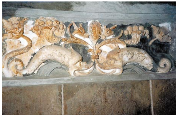
Jedna z poziomych ornamentalnych listew kopuły. Widoczne późniejsze uzupełnienia wykonane z gipsu i kitu cementowego
