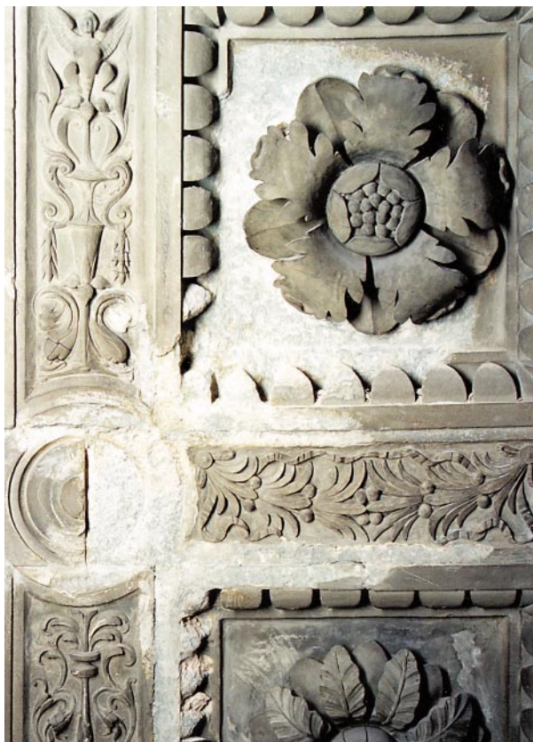
Typowe zniszczenia kamienia na ornamentach kasetonowych kopuły
