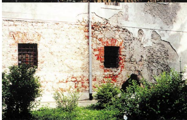
Ryc. 4. Widok obecnych zniszczeń tynku i muru ścian zewnętrznych elewacji zabudowań gospodarczych klasztoru (strona południowa i zachodnia). Fot. Leszek Sobol
