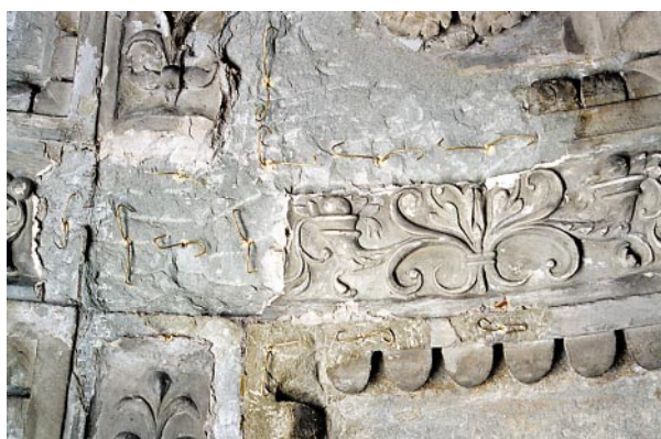
Zniszczony fragment kasetonów kopuły. Zbrojenie z drutów mosiężnych pod planowaną rekonstrukcję z masy sztucznego kamienia
