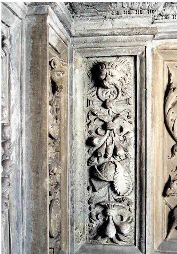
Naróżnik ściany ołtarzowej i tronowej. Dezintegracja powierzchni kamienia jednej z płycin groteskowych
