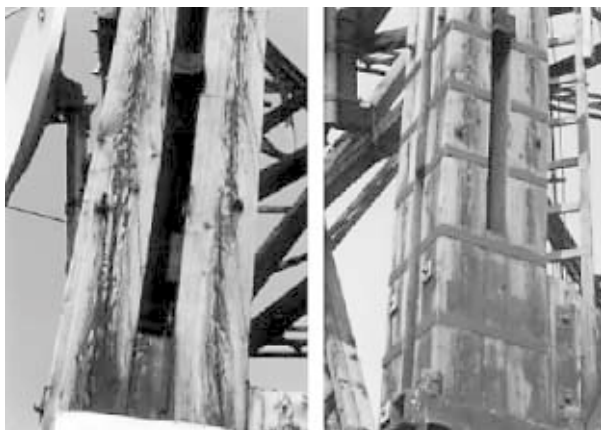
Rys. 1. Przykład pręta z poważnymi pęknięciami [1]
