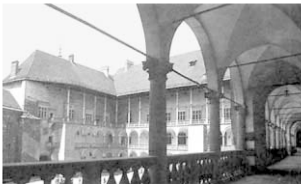
Rys. 1. Krużganki wawelskie wzmocnione zastosowanymi ściągnięciami stalowymi
