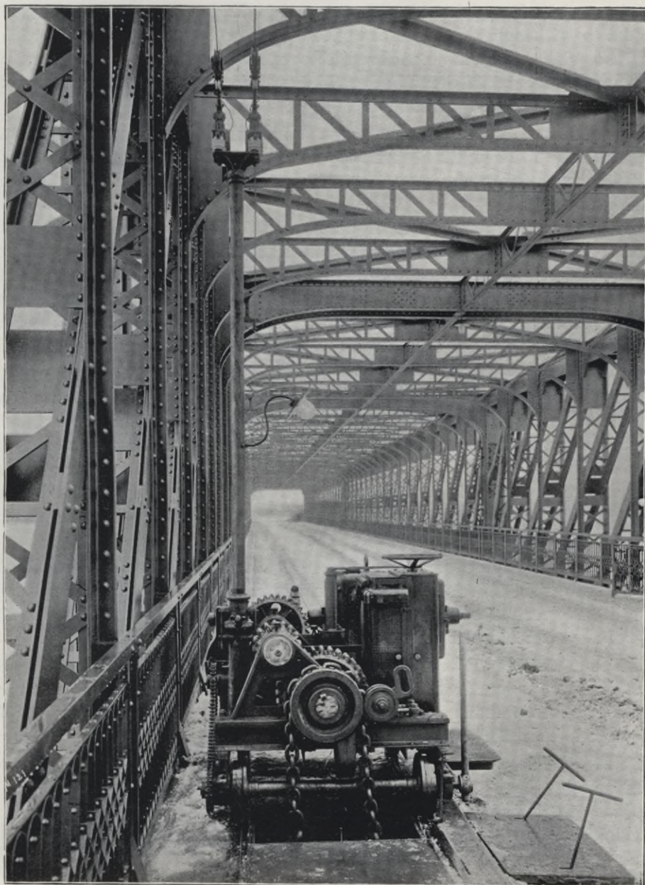
Nr. 11. Elektrische Winde zum Hinaufziehen der Losstände des Schützenwehres in Mirowie.
